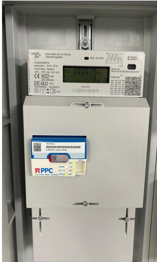
Basiszähler in 3 Punkt Ausführung
