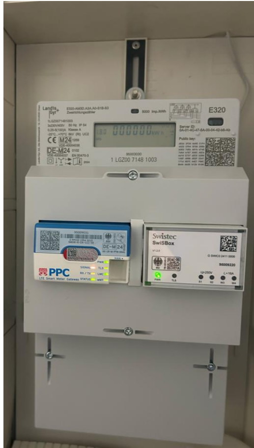
Basiszähler in 3 Punkt Ausführung
